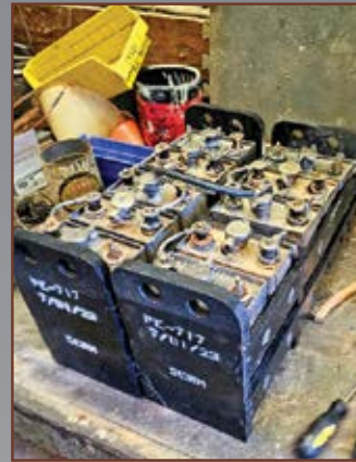
PE 717 batteries assembled
